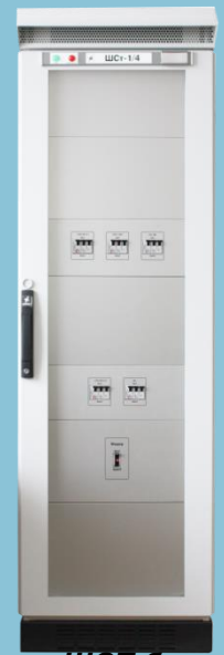
ШСт без резервування від АБ
