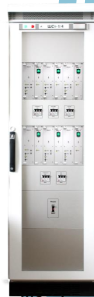
ШСт із резервуванням від АБ
