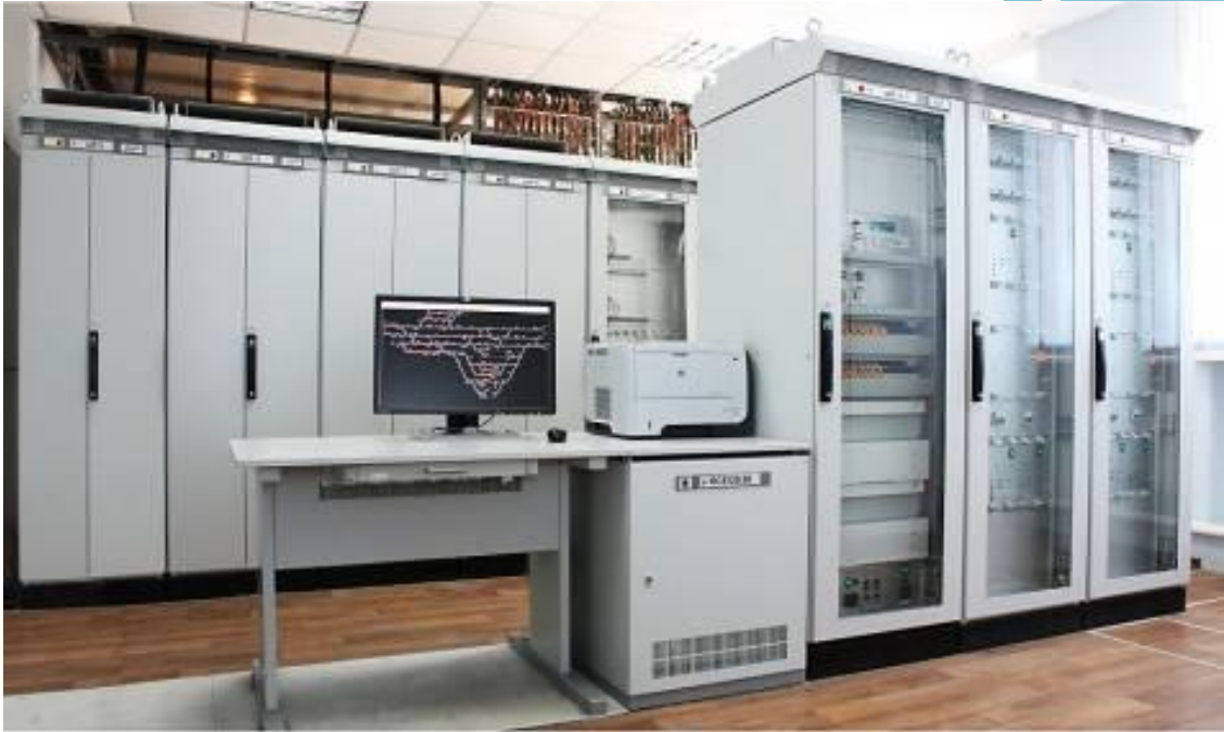
МПЦ-У на станції (релейне приміщення)
